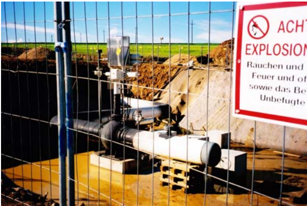
„West-Austria-Gasleitung WAG Plus 600“, Ansicht bei der Schieberstation Lichtenau
