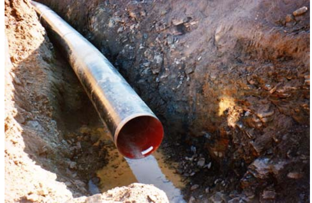
Leitungsrohr auf dem Grundstück Winkler.
